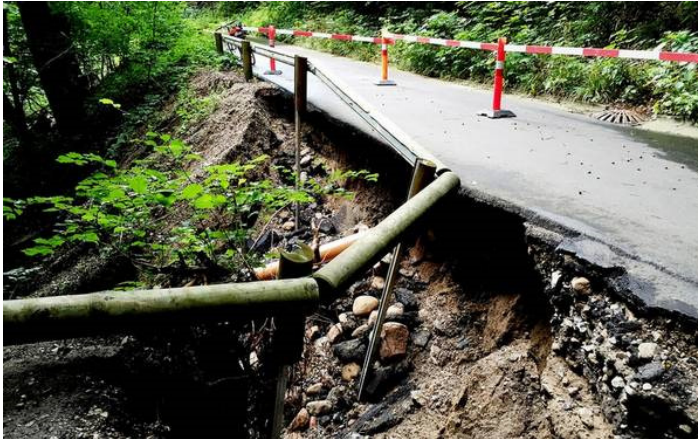
Lille Grundet Hulvej blev undermineret, da vandet strømmede ukontrollabelt ned fra Lille Grundet-området. Foto: Kaare Johansen
